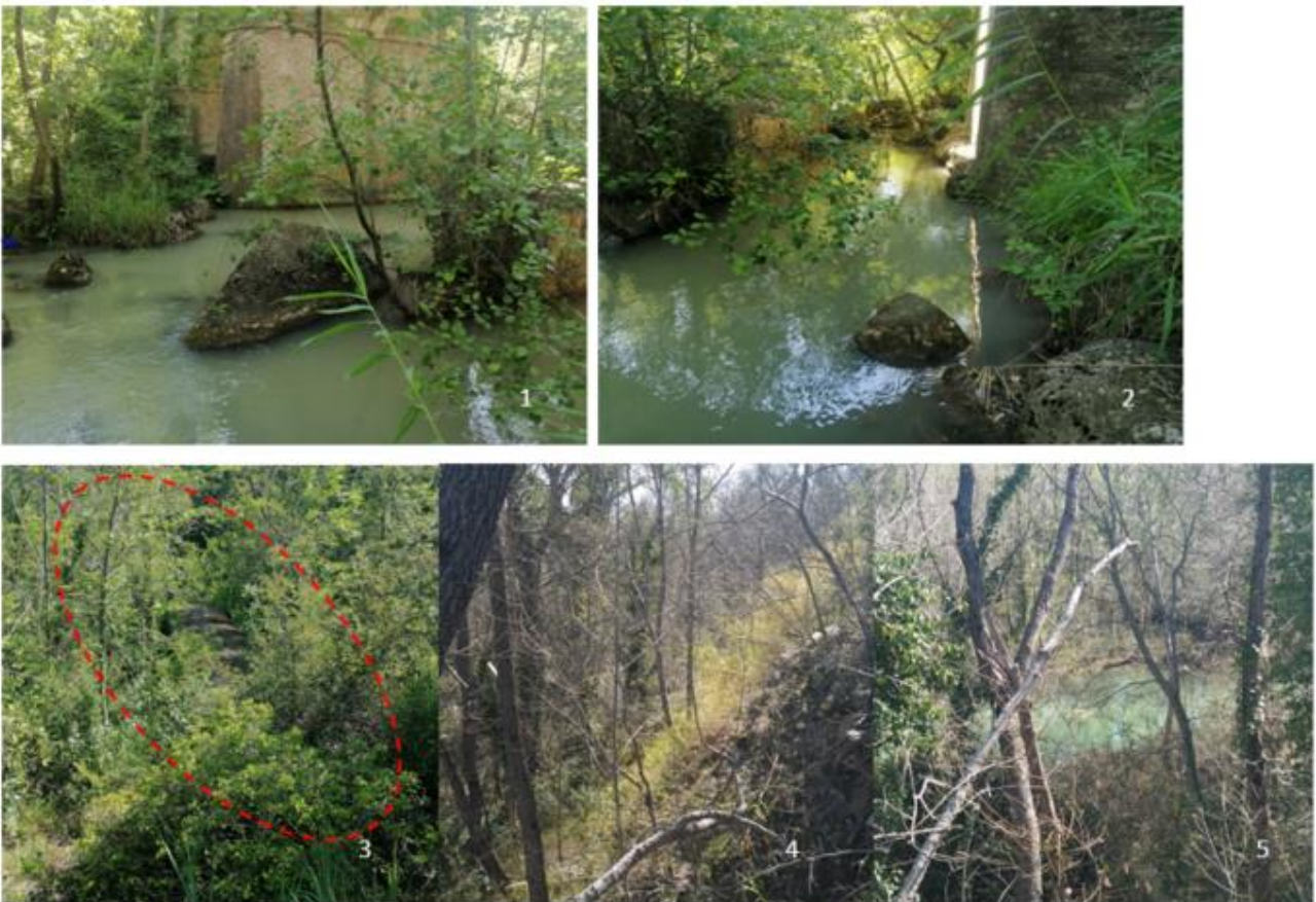
Foto 1-2 Ponte Sant'Antonio. Foto 3 pennello. Foto 4-5 scarpate erosive delimitanti l'area golenale.
